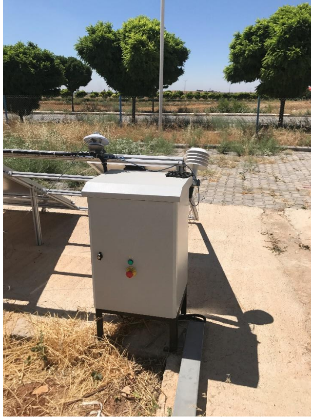
Ölçüm istasyonu panosu ve taşıyıcı sehpa
