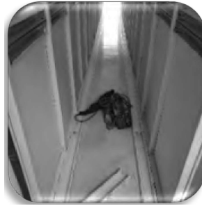
5.2 Elektrik ve İnternet Altyapısı
